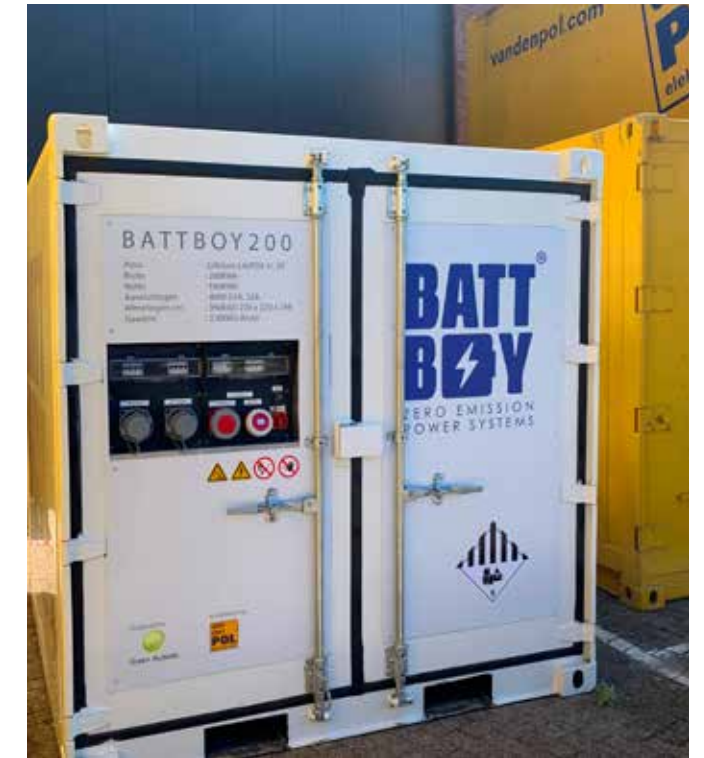
De BATTBOY, een verplaatsbaar accusysteem met een capaciteit van 60 tot 400 kWh.
